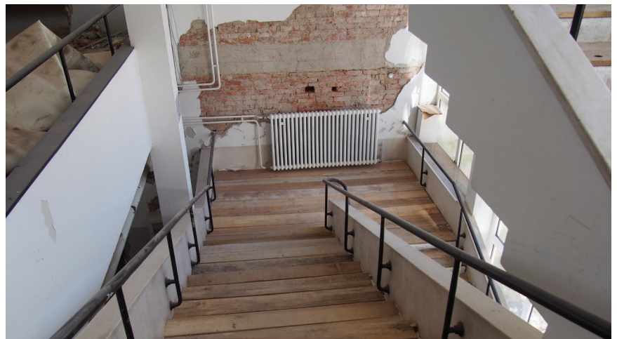
Oštećenja na zidovima stubišta
